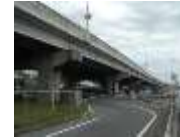
対象橋梁は、海岸から至近の距離にあり、塩害による劣化が著しい。
