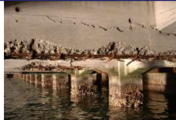
栈橋の鉄筋腐食(撮影:加藤絵万)
