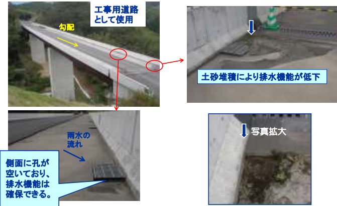
※土砂の堆積等によって、路面の排水機能に支障が生じる可能性がある。
