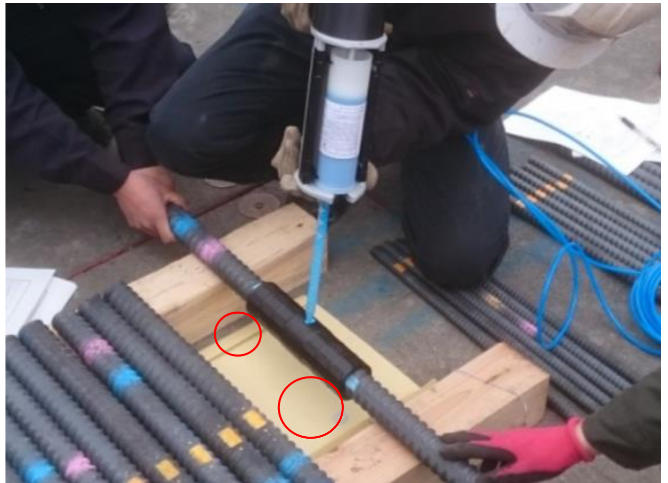
グラウト材のリーク
